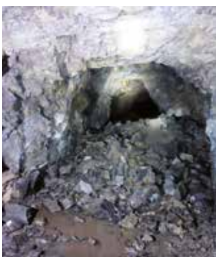
Bild 3: Bruchmassen im Stollen 1
